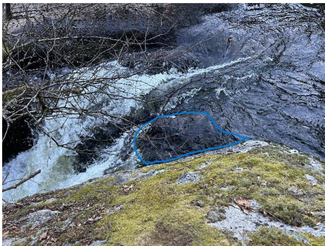
Figur 53. Steinblokk som bør fjernes helt eller delvis (tiltak 1) sett fra nordsiden av løpet.
