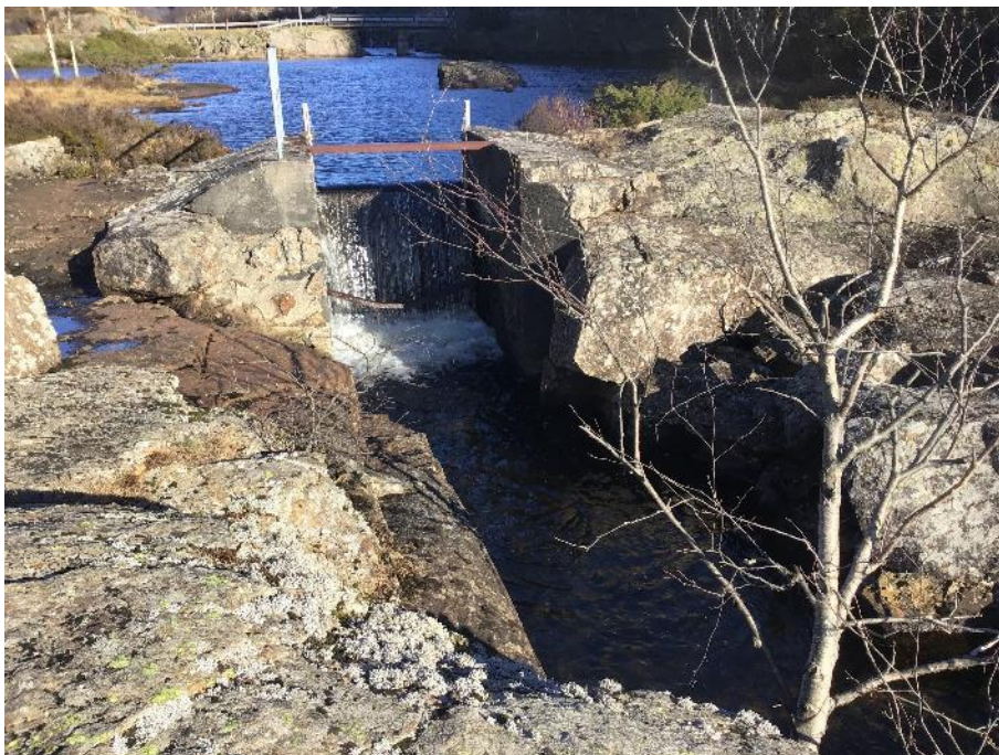
Figur 31. Over fossen er det to løp, hvorav det vestre er regulerbart overløp som driftes av Dalane Kraft. Høyden på dette spranget var 155 cm da bildet ble tatt, og ikke mulig å passere ved gitt vannføring. Som del av tiltaket må det tas høyde for at dette kan være en «blindvei».
